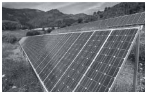
Figura 12.- Instal·lació solar fotovoltaica.
