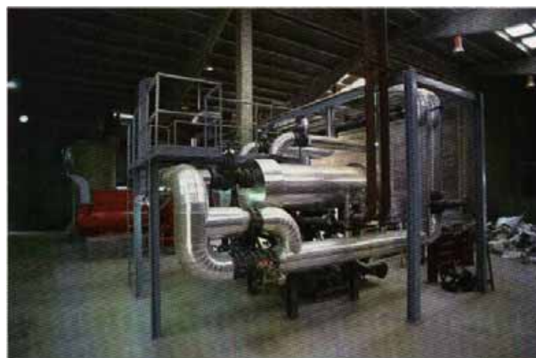
Secció de bescanvi de calor (vapor-aigua) del circuit de calefacció.
