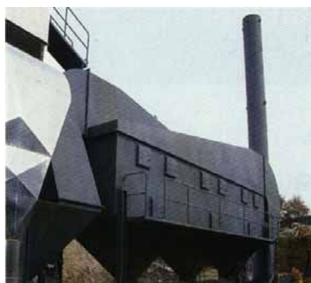
La planta compta amb un sistema de tractament dels gasos.
