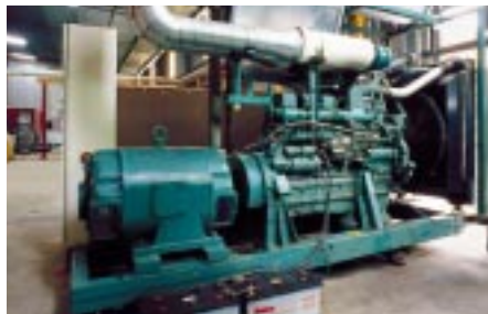
La planta compta amb dos motors convencionals de combustió interna i de quatre temps, que funcionen amb el sistema Dual-fuel.
