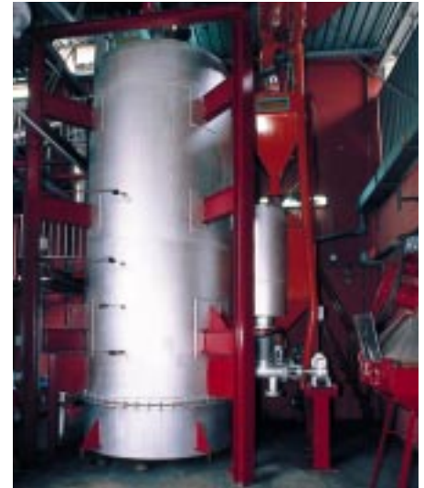
En el reactor-gasificador es produeix la termoconversió de la matèria orgànica sòlida en gas.
