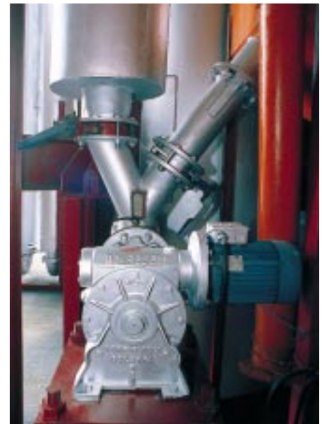
Molturador de la closca d'ametlla que alimenta el reactor-gasificador.
