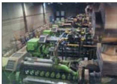
La planta de Juneda va produir l'any 2002, 116.000 MWh d'energia elèctrica.
