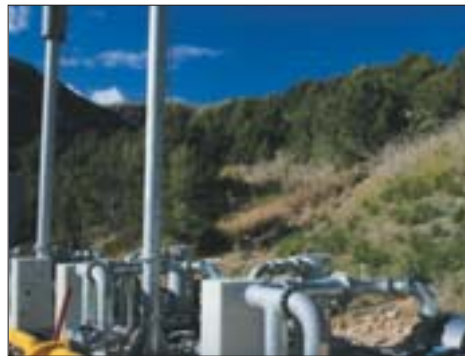
Els abocadors de residus sòlids urbans són una font inesgotable de biogàs
