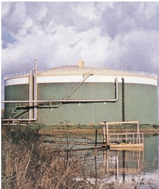
Planta de digestió anaeròbia d'aigües residuals.
